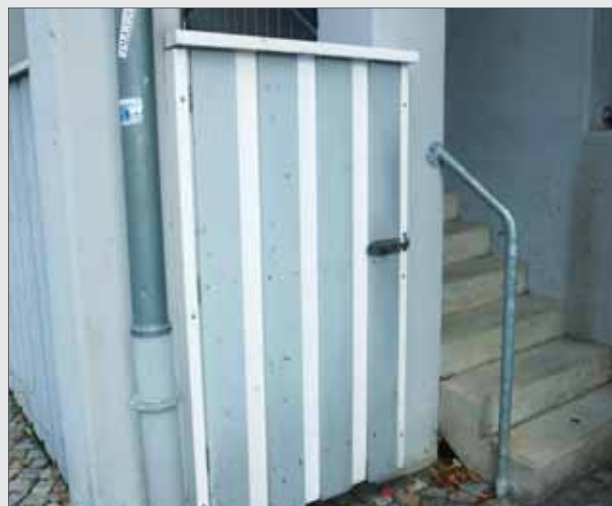
Sichtschutz TB D | Der Standort von mehreren Müllbehältern wird durch eine einfache Holztür gekonnt kaschiert
