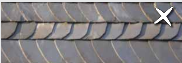
Unterschiedliche Verlegerichtungem der Schieferplatten | Auf Dachfläche nicht gewünscht
